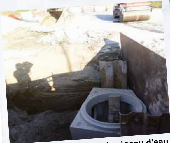
1 mois de travaux sur le réseau d'eau pluviale du rond point de Sénailiac au bassin d'étalement d'Artigues
