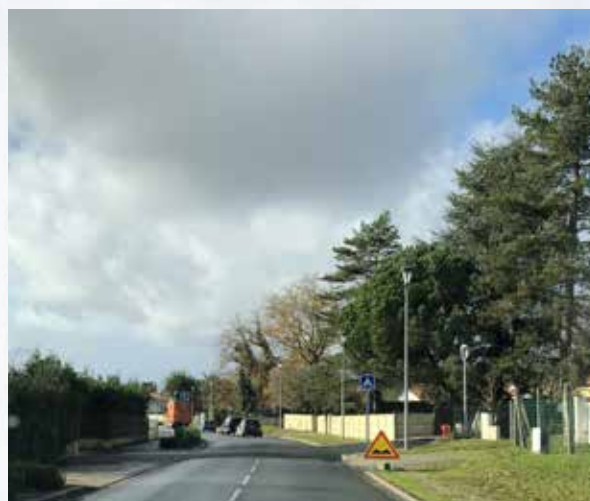
Réalisation d'un ralentisseur Avenue des trois lieues afin de réduire la vitesse et faciliter la sortie du lotissement du Tasta.
